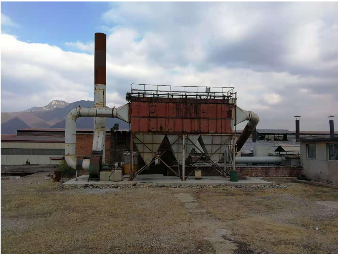
工频电炉熔化废气治理设施
