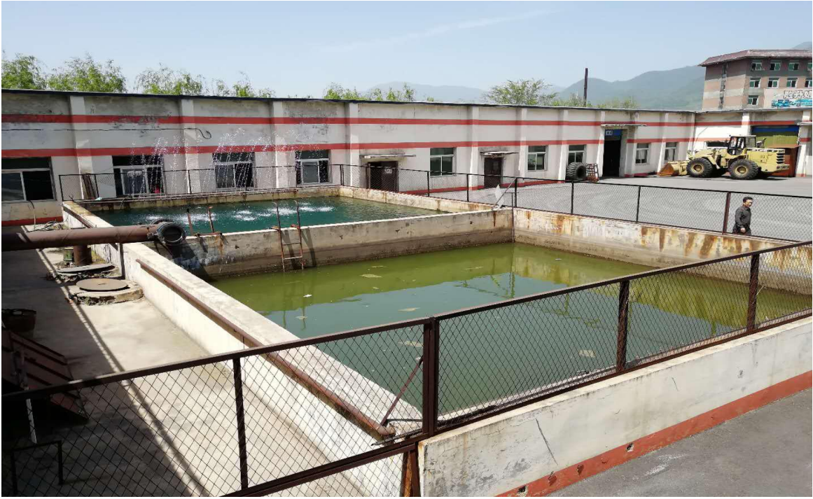
工频电炉循环水池
