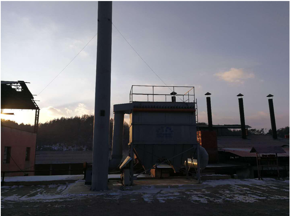
工频电炉熔化废气治理设施
