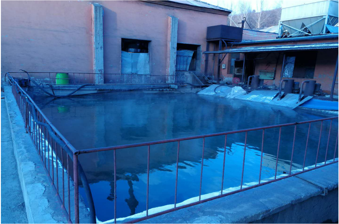
工频电炉循环水治理设施
